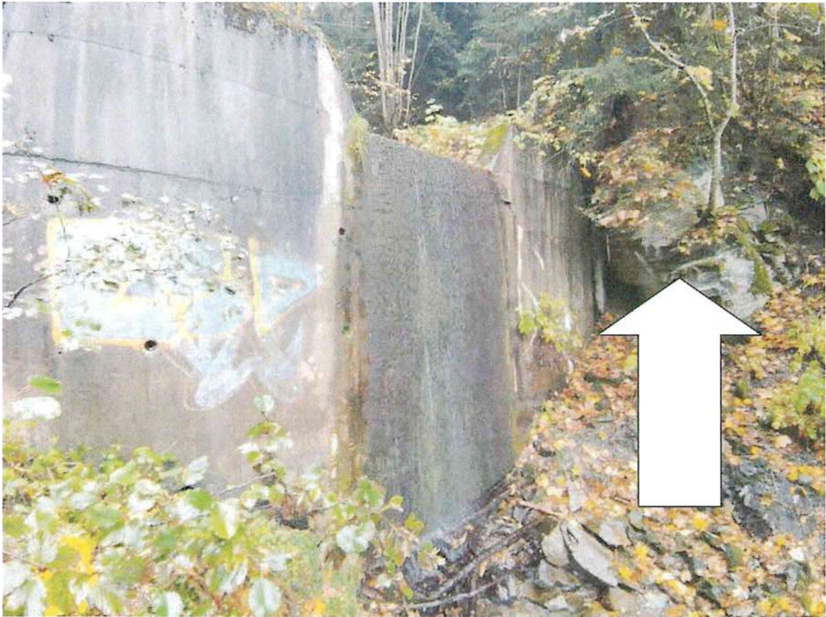
VUE DU BAS AVEC HEUREUSEMENT LA FONDATION LATERALE GAUCHE TENUE PAR UN ROCHER
